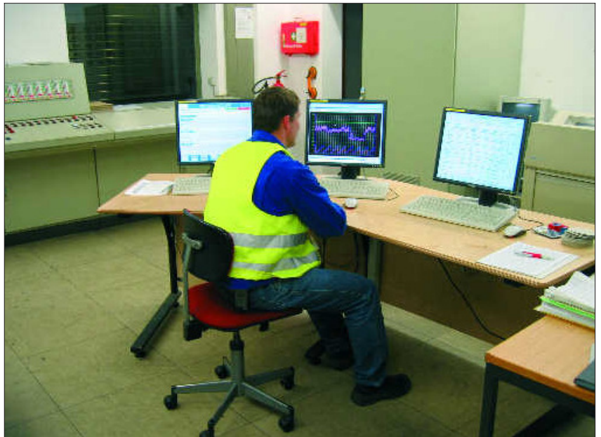
Über das Prozessleitsystem Simatic PCS7 werden von der Leitwarte aus alle Aufbereitungs- und Produktionsschritte in der Pappfabrik gesteuert und überwacht
